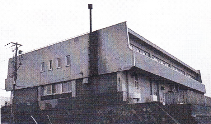
▲老朽化が進む社会福祉会館
