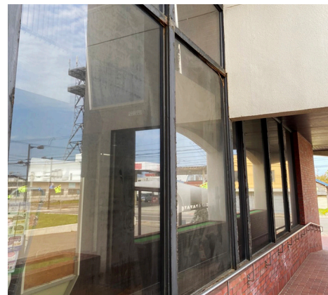
▲老朽化が進む役場庁舎
