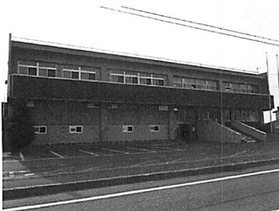
長年経過による老朽化が目立つ社会福祉会館
