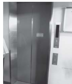
給食用エレベーター
